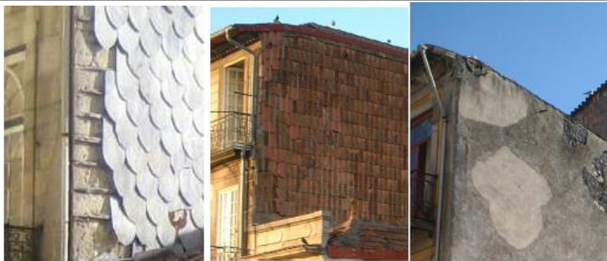
Figura 6. 15 (Em cima à esquerda) – Revestimento em azulejo (Fonte: Cidadania LX, 2016); Figura 6.15 (Em cima ao centro) – Revestimento em barramento asfáltico; Figura 6.16 (Em cima à direita) – Revestimento em chapa ondulada; Figura 6.17 (Em baixo à esquerda) – Revestimento em soletos de ardósia; Figura 6.18 (Em baixo ao centro) – Revestimento em telha vã; Figura 6.19 (Em baixo à direita) – Revestimento em reboco (Fonte: Teixeira, 2013a)
