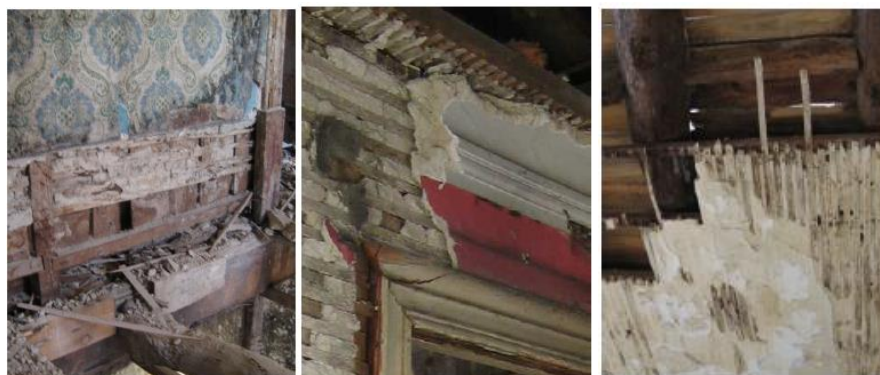
Figura 6.27 (Esquerda) – Pormenor de transição entre parede de tabique e sobrado; Figura 6.28 (Centro) – Pormenor de transição entre parede de tabique e teto em estuque; Figura 6.29 (Direita) – Estrutura do fasquiado que suporta teto em estuque (Fonte: Teixeira, 2013a)
