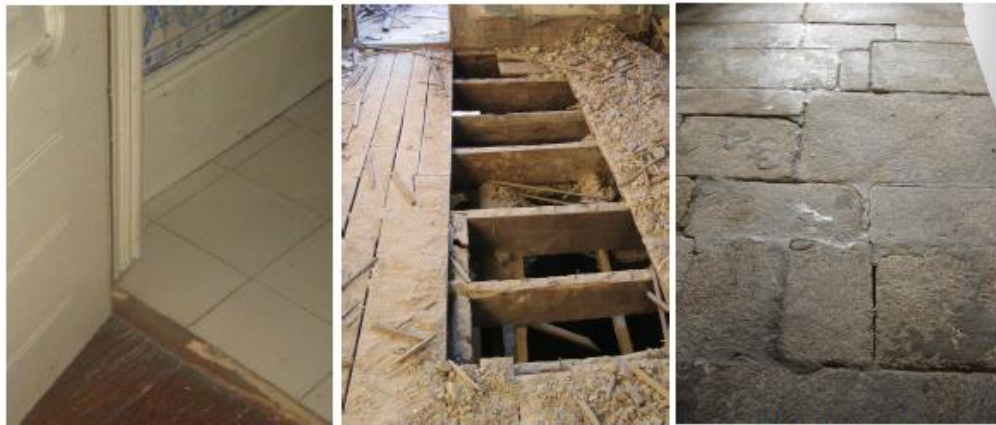
Figura 6.24 (Esquerda) – Revestimento impermeável sobre o soalho; Figura 6.25 (Centro) – Estrutura dos sobrados em vigas esquadriadas; Figura 6.26 (Direita) – Revestimento do piso térreo lajeado (Fonte: Teixeira, 2013a)
