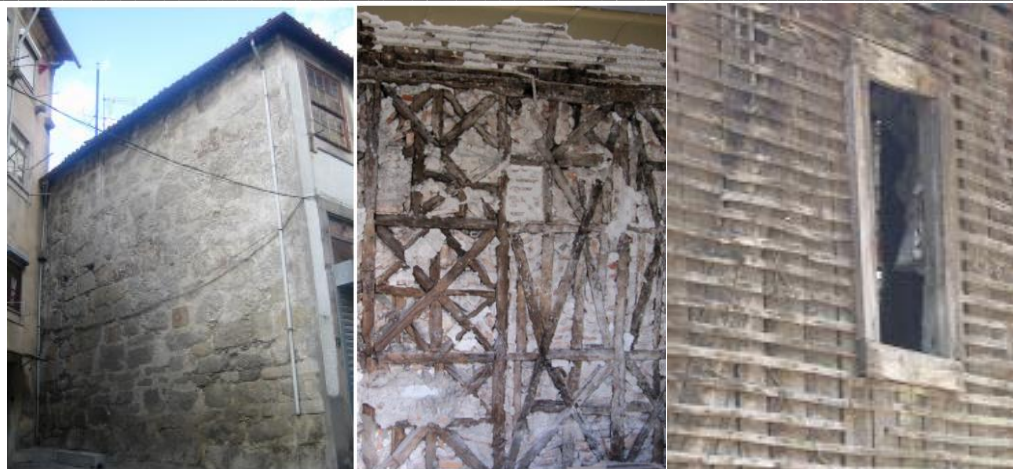
Figura 6.2 (Esquerda) – Parede de meação em alvenaria de granito (Fonte: Teixeira, 2013a); Figura 6.3 (Centro) – Parede executada em frontal (Fonte: Mouzinhohabitacao, 2016); Figura 6.4 (Direita) – Parede executada em tabique (Fonte: Arquitecturadoiro, 2016)
