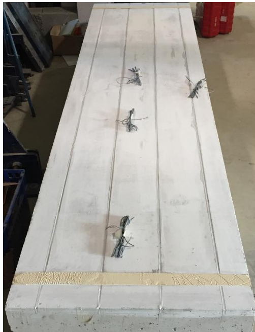
Figura 3.26 - Faixa de laje reforçada com sistema NSM, após a pintura da superfície para identificação de fendas.
