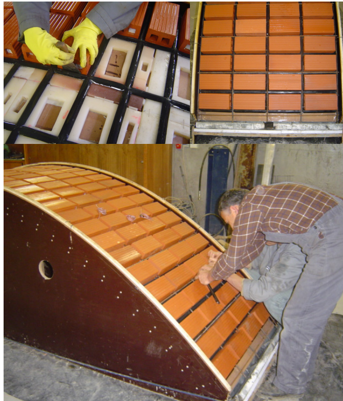
Figura 4 – Posicionamento dos tijolos cerâmicos no molde(a); Vista dos tijolos posicionados(b); Posicionamento das armaduras nas juntas e do molde da casca(c).
