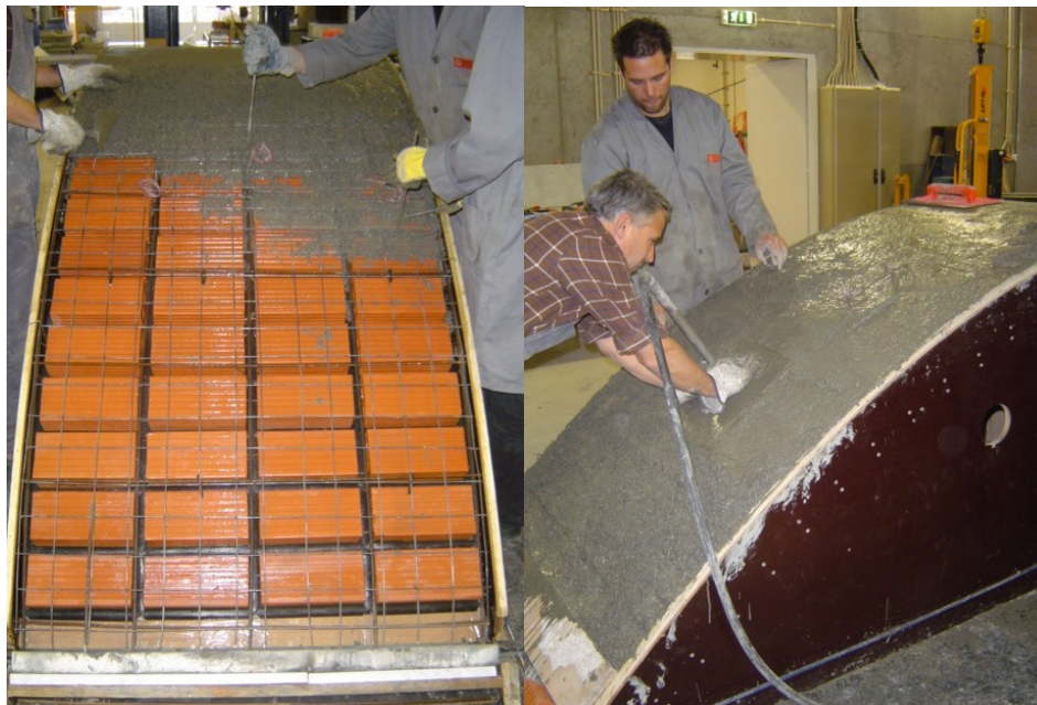
Figura 6 – Betonagem da casca, após o posicionamento da malha electrossoldada(a); Utilização do vibrador(b).
