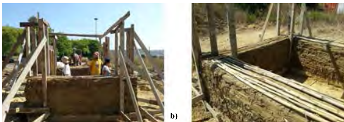
Figura 6. Protótipo 3: (a) Vista geral da construção das paredes pelos estudantes; (b) Detalhe da construção com a aplicação de uma camada de canas.
