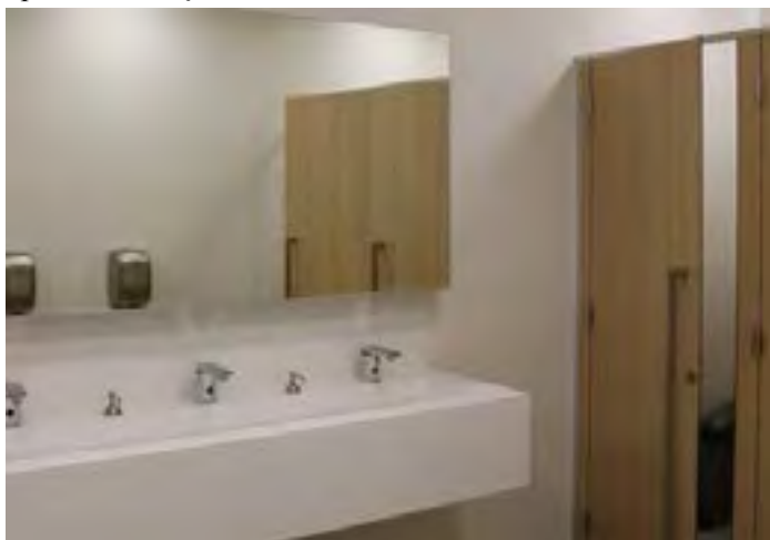
Figura 15. Torneiras com sensor nas instalações sanitárias.
