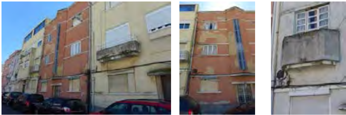
Figuras 7 - Fachadas degradadas de edificios recentes. (Reaes Pinto)
