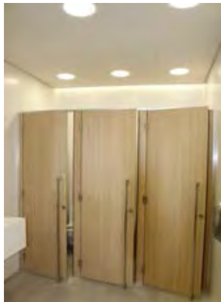
Figura 10. Luminárias das instalações sanitárias.
