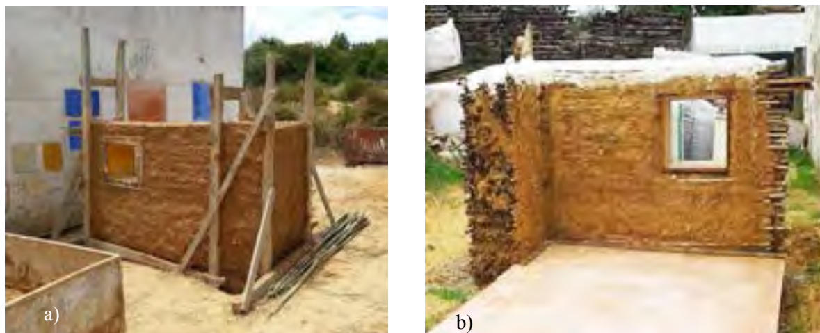
Figura 2. Protótipo 2: (a) Vista da face Sul com cimbres; (b) Vista Norte sem cimbres.
