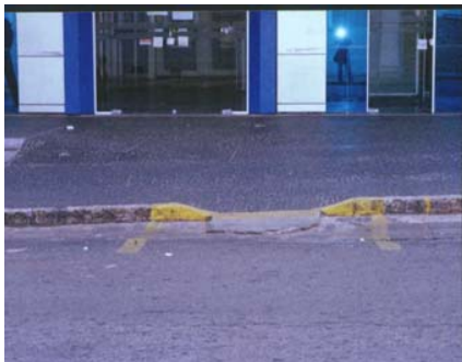
Foto 3 Guia inadequada defronte entrada de Agência Bancária
