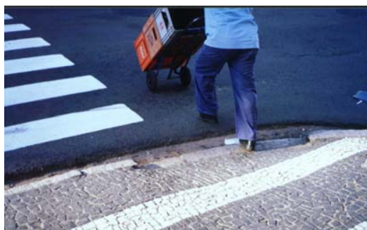
Foto 7 Guia inadequada na Av. Rodrigues Alves – travessia de carrinho de mercadorias
