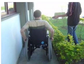
Fig.39 Acesso estreito Caminho de acesso ao refeitório é exíguo.
