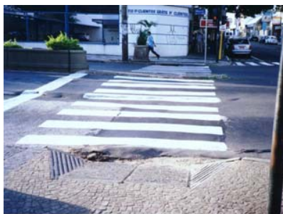
Foto 4 Guia inadequada na Av. Rodrigues Alves e irregularidade no asfalto
