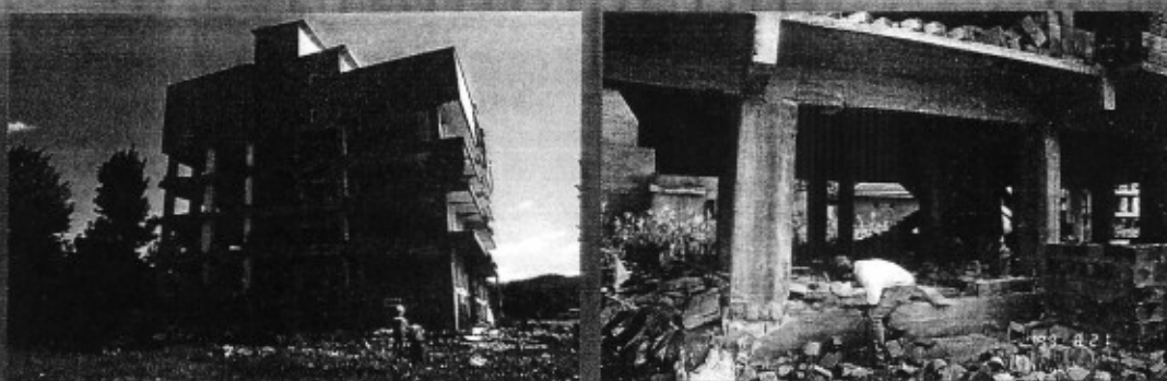
Figura 8 - Derrube e queda de paredes de alvenaria de enchimento devida ao efeito de um sismo
