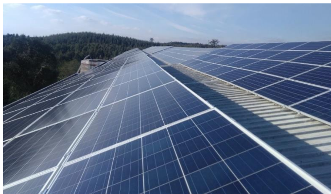
Figura 7.25 - 1250 painéis FV policristalinos de 255 W com suporte em alumínio. Foto cedida pela DAPE.
