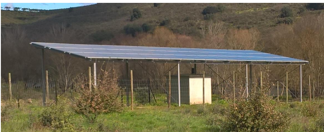
Figura 8.30 - painéis FV de 250 W. Foto do autor.
