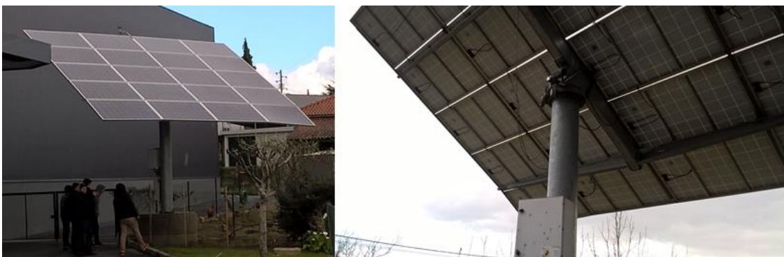
Figura 6.12 – sistema FV com painéis FV, seguidor de 2 eixos e quadro de funcionamento do seguidor e de proteção instalado pela DAPE. Foto do autor.
