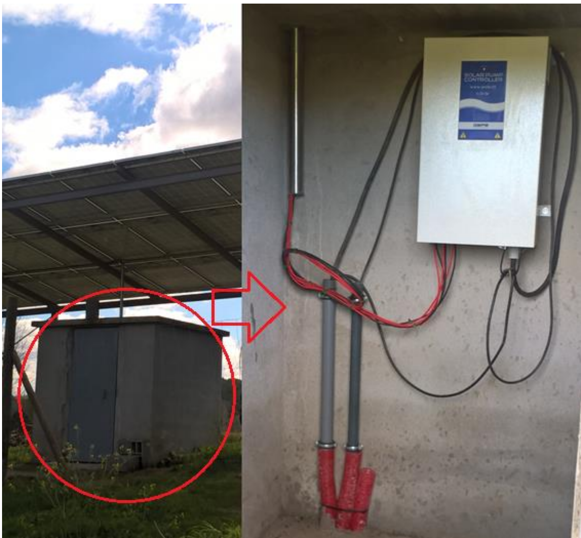
Figura 8.32 – painéis FV, habitáculo e controlador solar CBS 110001 de 11 kW. Foto do autor.
