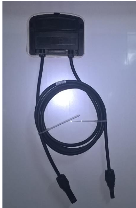
Figura 2.64 - caixa de conexão, cabos e conectores solares MC4. Foto do autor.
