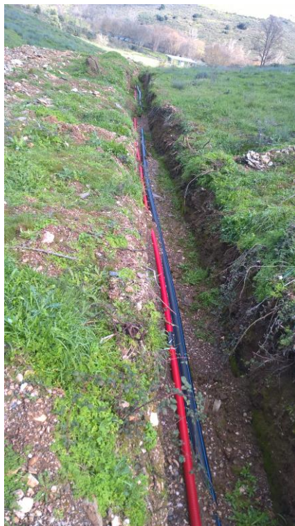
Figura 8.28 - . tubo de água (tubo preto com risca azul) e o tubo de cabos elétricos (tubo vermelho) que ligam a eletrobomba, painéis e o lago (reservatório). Foto do autor.
