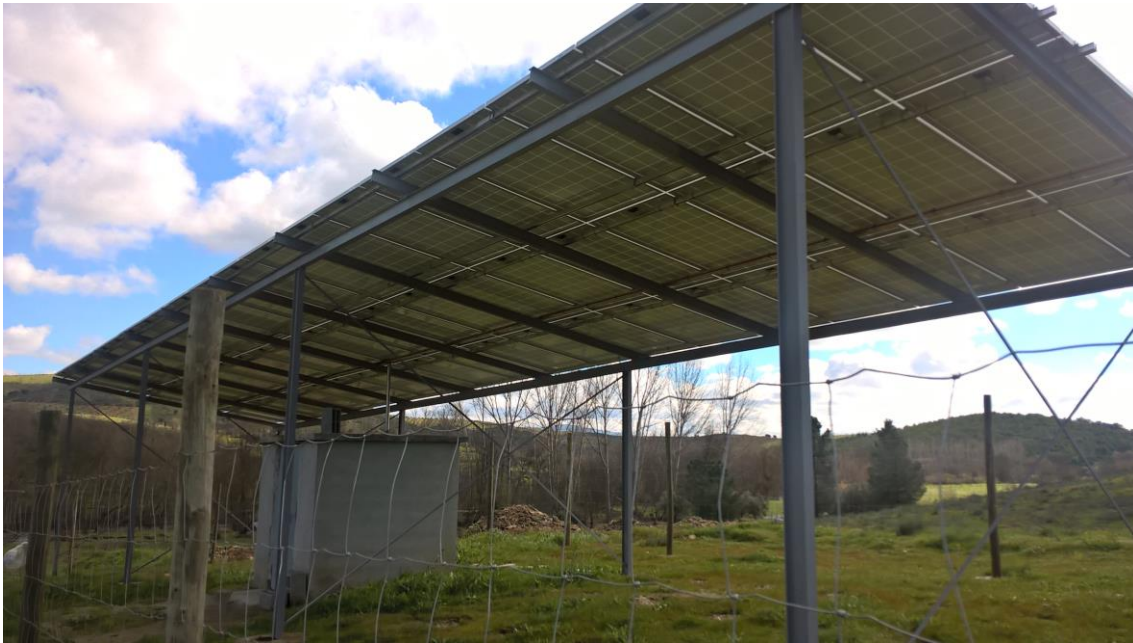
Figura 8.31 - painéis FV de 250 W. Foto do autor.
