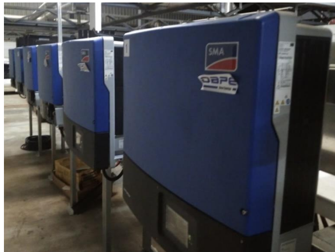
Figura 7.24 - inversores SMA de 25 kW. Foto cedida pela DAPE.
