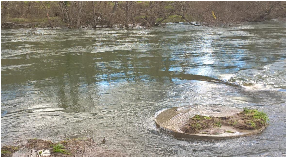
Figura 8.25 - eletrobomba submersa FT62710 de 11 kW com sensor de nível no rio Rabaçal. Foto do autor.
