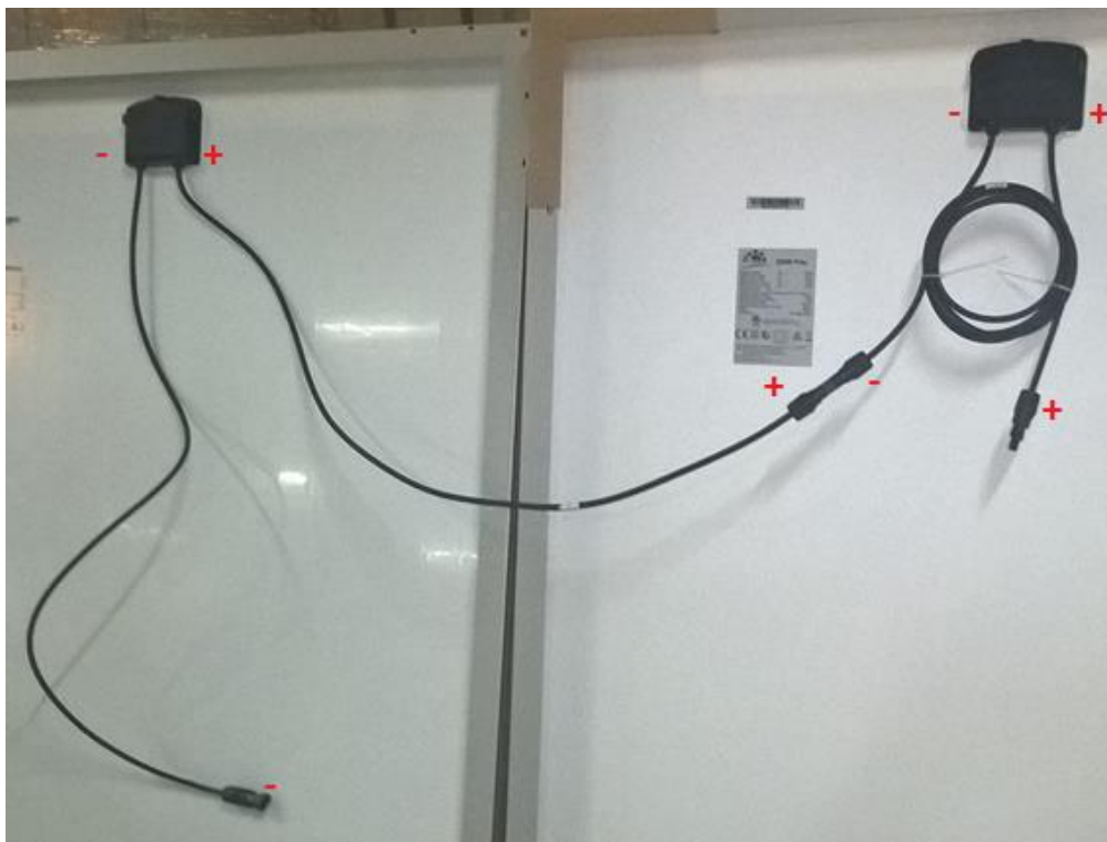
Figura 2.66 - Ligação em série de 2 módulos FV. O conector solar MC4 positivo do painel á esquerda liga ao conector solar MC4 negativo do painel á direita. Os restantes conectores solares MC4 ligarão ao inversor ou a um controlador de carga. Foto do autor.
