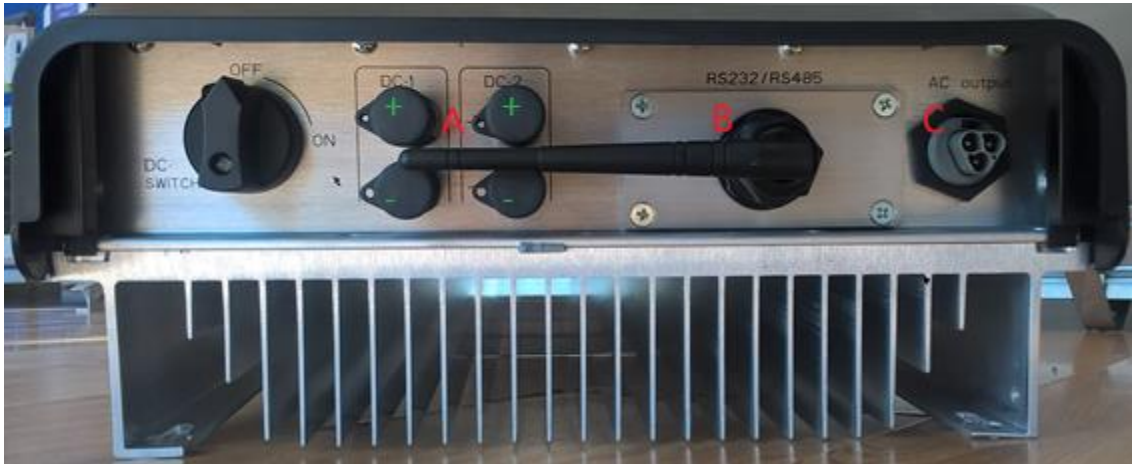
Figura 3.7 – as ligações do inversor ao sistema fotovoltaico: A – ligação de CC dos conectores solares MC4 positivo e negativo; B – interface RS232/RS485 que faz a ligação a um computador, via wireless, para monitorizar; C - ligação da CA à RESP. O inversor grid-tie tem também um botão on-off. [18]
