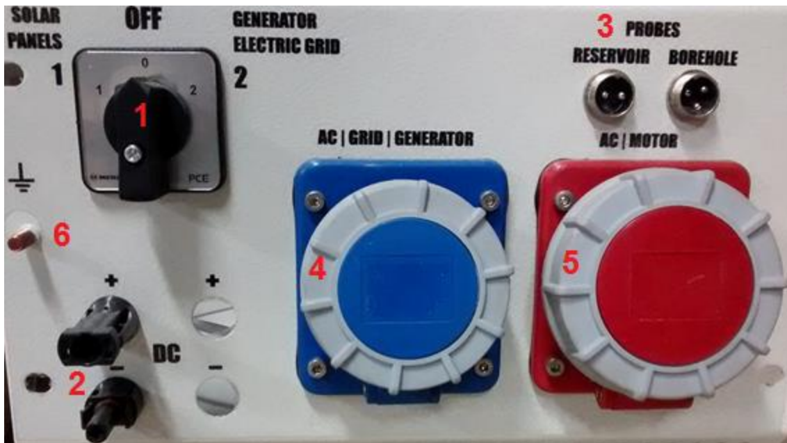
Figura 8.14 - controlador solar da empresa DAPE. (1) tem um comutador para o FV, RESP ou gerador de energia como o motor a diesel ou outro tipo de fonte de energia. Se não houver energia solar suficiente, o controlador vai buscar o que falta à RESP para trabalhar a 100%. O OFF desliga o controlador. (2) ligação dos painéis FV em CC aos conectores solares MC4. (3) tem duas ligações às sondas, uma para a boia do reservatório e outra para os sensores do furo, poço, lago, rio ou canais de água (4) entrada gerador/ rede em C.A. (5) ligação da eletrobomba (6) ligação à terra. Foto do autor.
