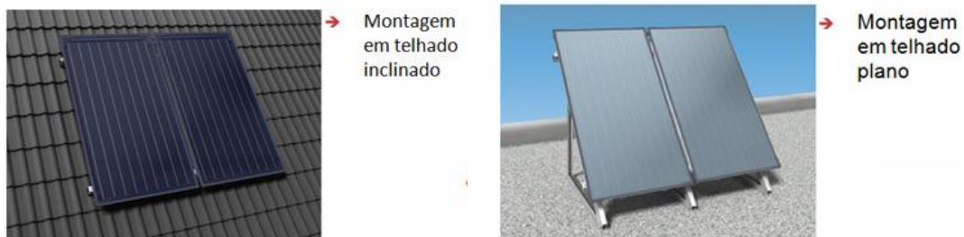
Figura 12: Coletores solares térmicos montados em telhados.
