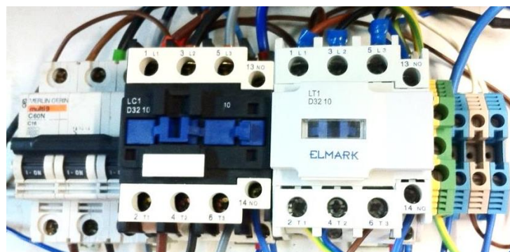
Figura 5.36 – Disjuntor trifásico e contactores trifásicos utilizados na bancada de ensaios do sistema microeólico.
