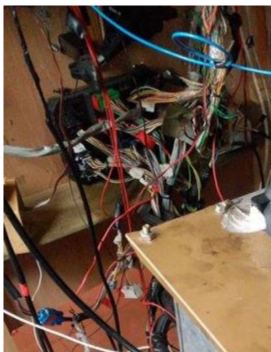
Figura 68 - Caixa de fusíveis BSI
