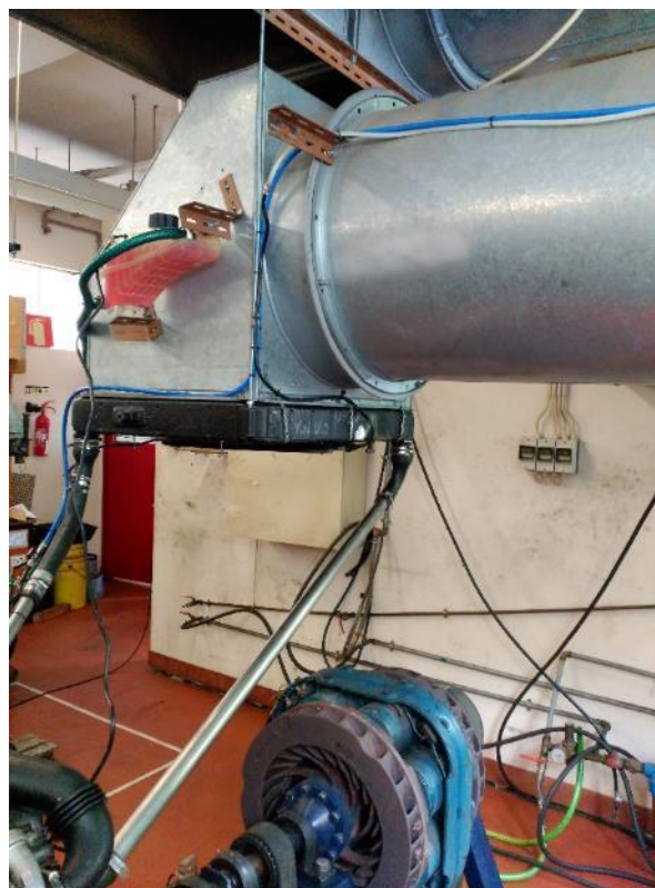
Figura 36 - Nova instalação do circuito de arrefecimento do motor
