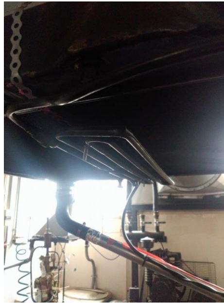
Figura 65 - Arrefecedor do retorno do combustível instalado no radiador
