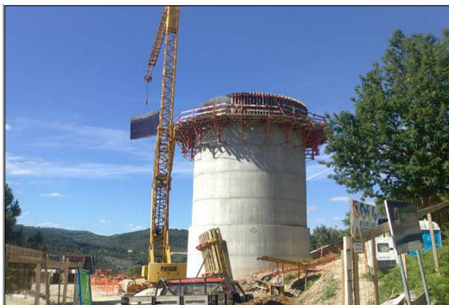
Figura 2.12 - Construção de chaminé de equilíbrio do aproveitamento hidroelétrico de Canedo (Renewable Technology, 2015).
