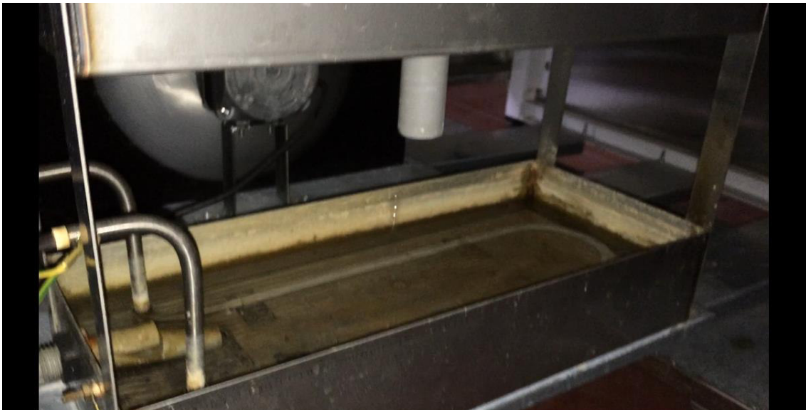
Figura 38 - Sistema de eliminação de condensados instalado
