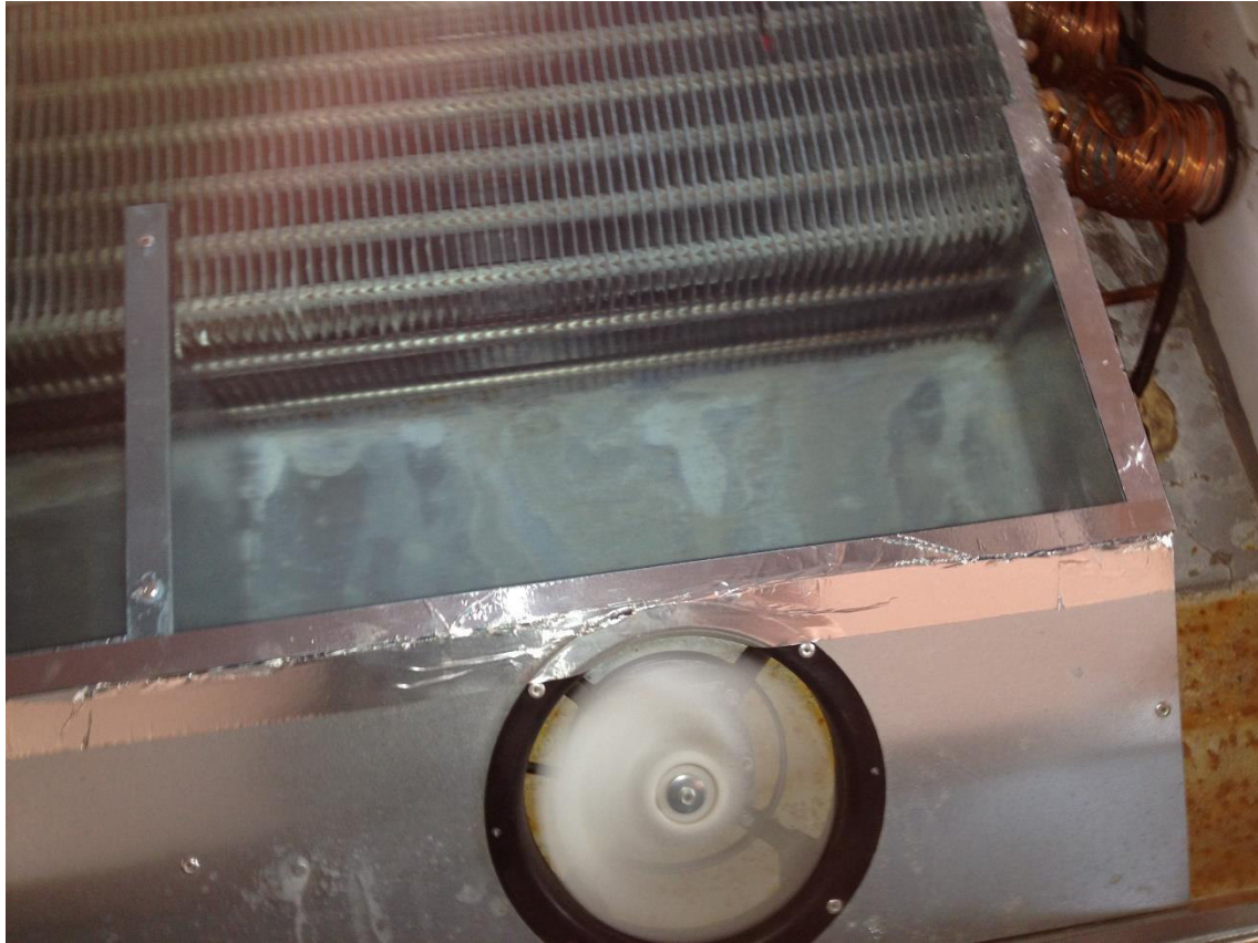
Figura 32- bandeja de acumulação de condensados
