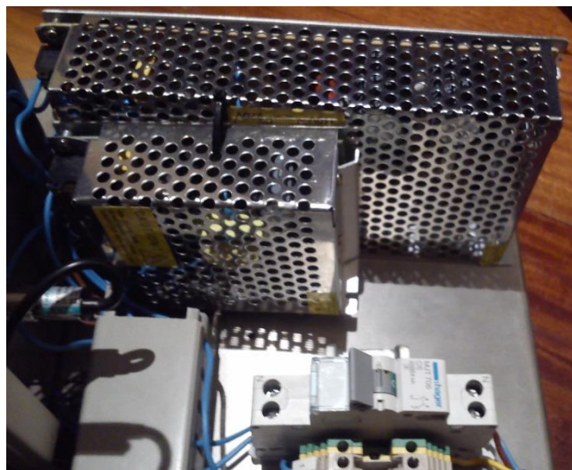
Figura 41 - Fontes de alimentação, de 24V DC e 12V DC e entrada de alimentação da bancada didática
