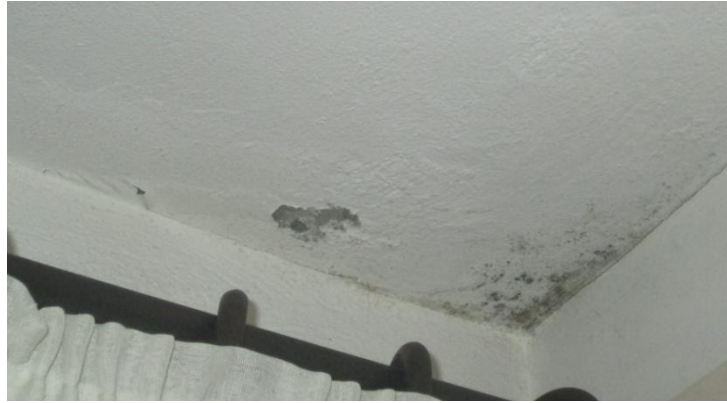
Figura 24 – Vista interior do teto do quarto da habitação 1
