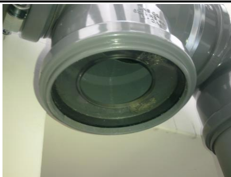
Figura 4.8 – Disco de encaixe aplicado no Segundo Depósito de Águas de Lavagem
