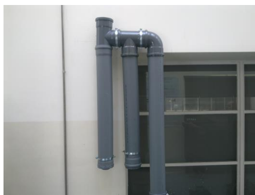
Figura 4.2 – Primeiro e Segundo Depósito de Águas de Lavagem
