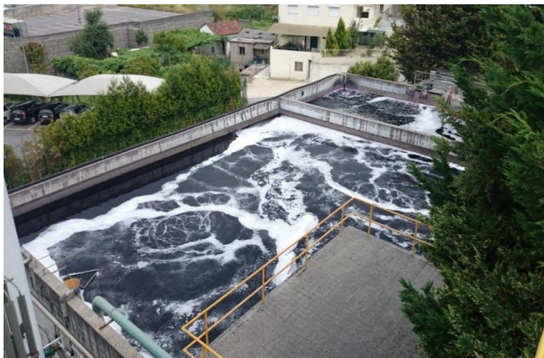
Figura 37 - Tanque de equalização.
