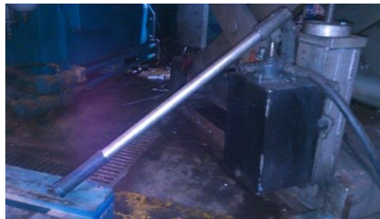
Figura 36 - Sistema Hidráulico manual do forno de manutenção
