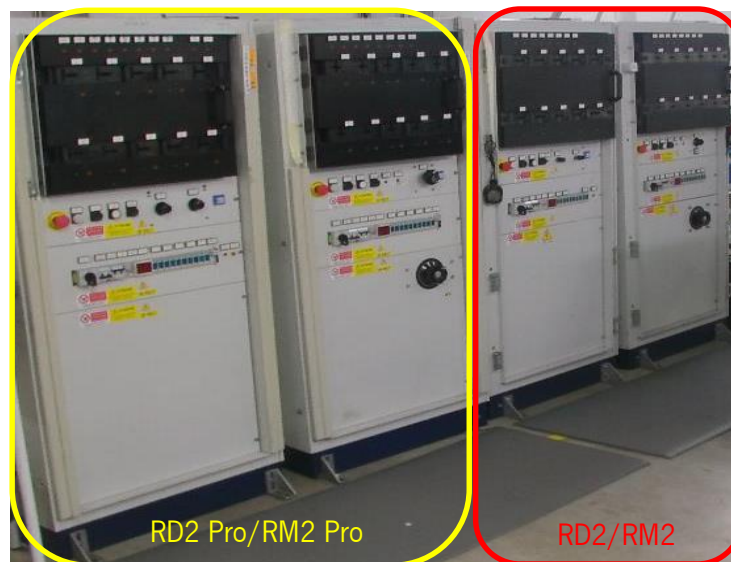
Figura 81 – Uniformização das máquinas de acordo com a versão do produto.
