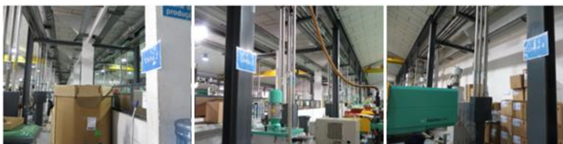
Figura 48 - Identificação das restantes linhas de injeção
