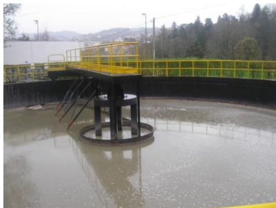
Figura 2.4 - Tratamento primário – Sedimentador. Disponível em http://csgquiagua.webnode.pt/etar/tratamentos-de-aguas-residuais/tratamento-primario/ (consultado em janeiro 2013)
