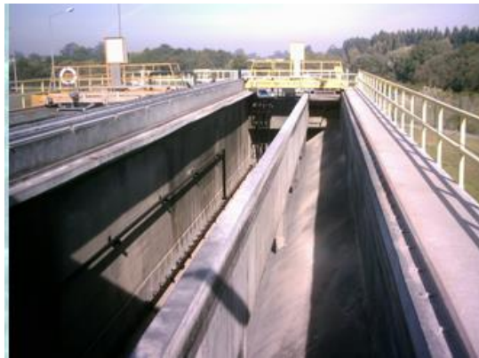
Figura 2.3 - Tratamento preliminar – desarenador arejado. Disponível em http://www.eb1-albergaria-velha-n1.rcts.pt (consultado em janeiro 2013)
