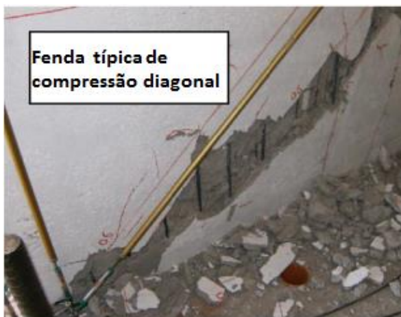
Figura 2.26: Fenda de compressão diagonal (Pavesa e Bournas, 2011)
