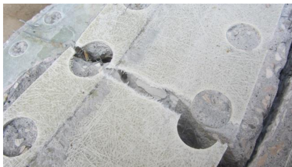
Figura 3.36: Integridade do betão entre furos
