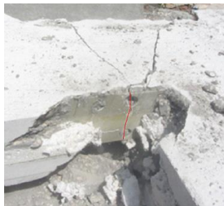
Figura 5.47: Rotura do conector.
