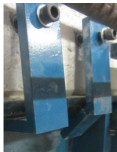
Figura 5.42: Rotura dos elementos de fixação vertical
