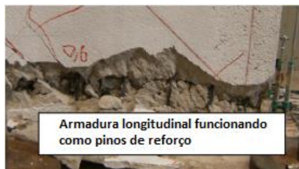
Figura 2.27: Fenda horizontal na base dos painéis (Pavesa e Bournas, 2011)
