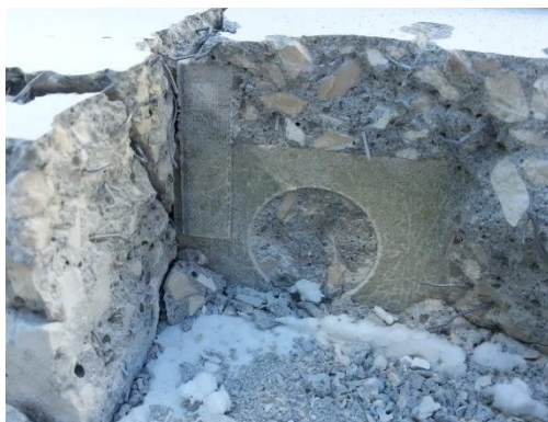
Figura 4.44: Adesão do betão ao conector, próximo da abertura de fendas
