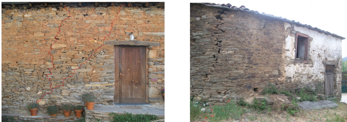
Figura 3.41 – Fendas diagonais (Carrazedo de Montenegro).
