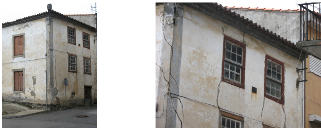
Figura 3.42 – Diversas fissuras nas paredes originadas pela alteração do meio circundante à construção (Bragança).
