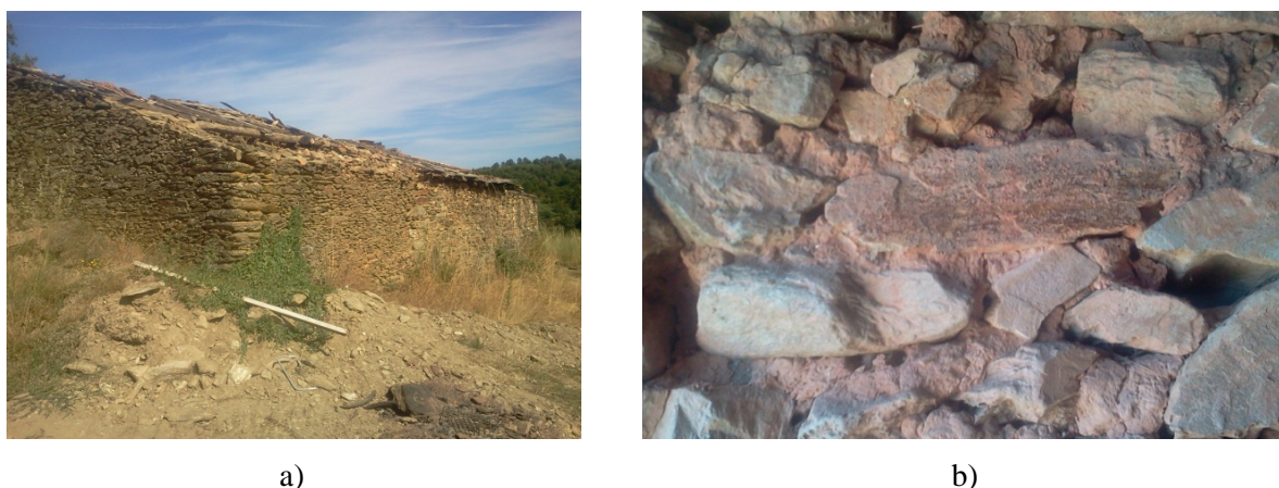
Figura 5.1 – Construções de onde foram extraídas as amostras de argamassa de terra para caracterização: a) Local de extração da amostra A; b) Local de extração da amostra B.
