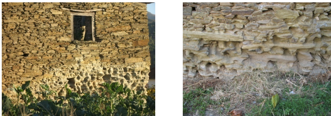
Figura 3.36 – Erosão do xisto numa habitação na zona de Arganil.
