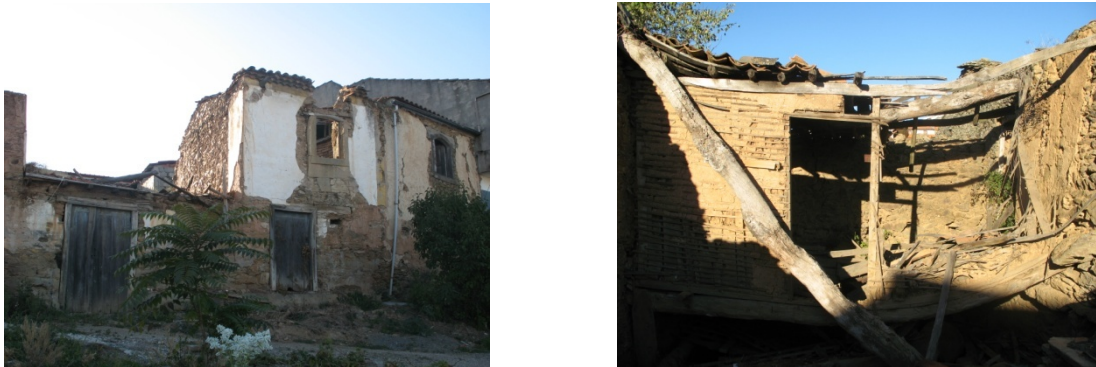
Figura 3.47 – Construções de xisto em estado de ruína (Santa Maria de Émeres).
