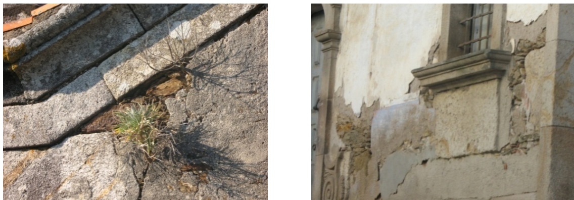
Figura 3.39 – Deterioração e destacamento do reboco (Vilar de Mouros).
