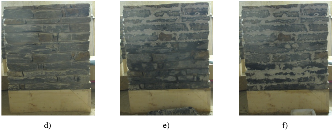
Figura 5.31 – Diferentes fases do processo de preenchimento de junta: a) Argamassa removida; b) Preenchimento das juntas de metade da parede; c) Preenchimento das juntas de toda a parede.
