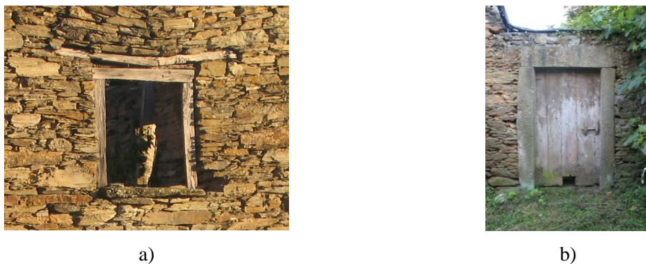
Figura 3.12 – Lintéis: a) madeira (Gimonde); b) granito (Vilar de Mouros).
