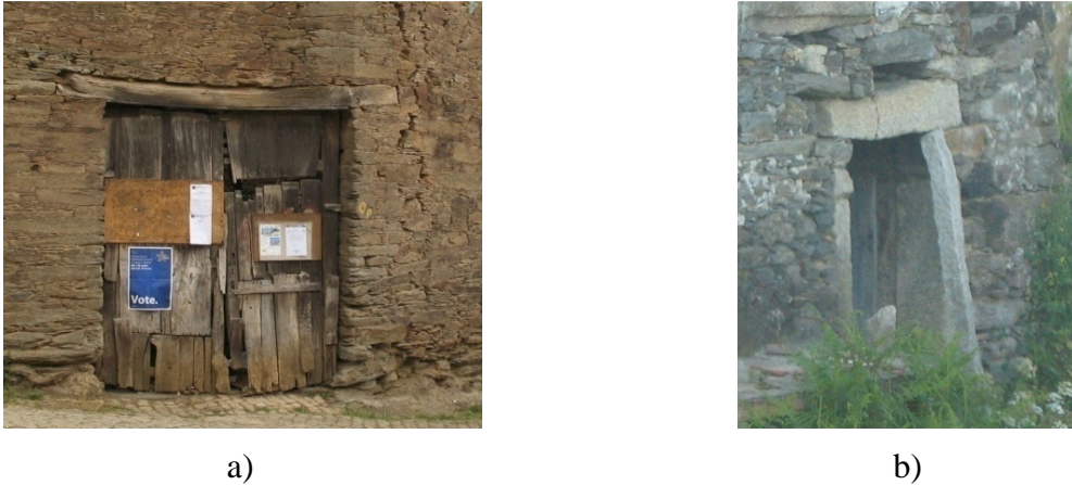
Figura 3.40 – Danos em padieiras: a) flexão em padieira de madeira (Gimonde); b) fissura em padieira de granito (Vilar de Mouros).
