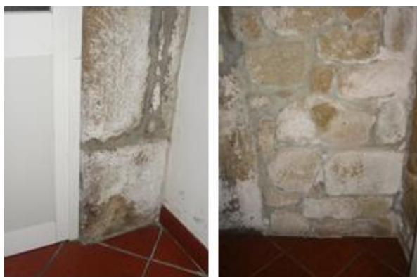
Figura 27 - Eflorescência no hall e lavandaria
