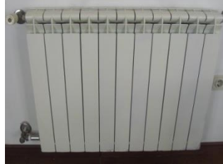
Figura 19 - Radiador de aquecimento
