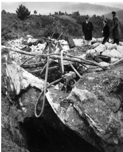
Sarilho, guincho e tubagens para extracção de água (com motor) em poço inclinado. Fotografia relativa à Concessão de Vilarinho nº 4 (Cabração, Ponte de Lima) (Plano de Lavra, 1955 - Dossiê n.º 3091).
