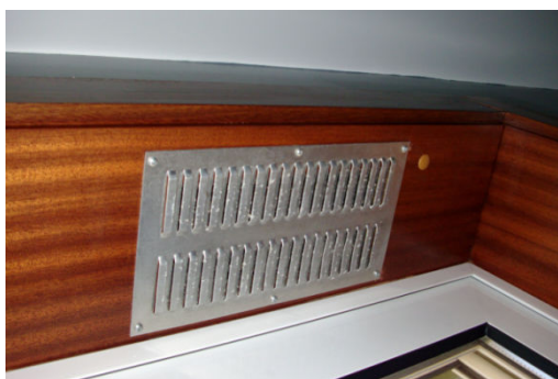
Figura 25 – Grelha de exaustão e admissão de ar no Edifício A.
