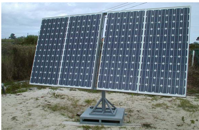
Fig. 2 - Unidade de fixação e orientação dos painéis solares.
