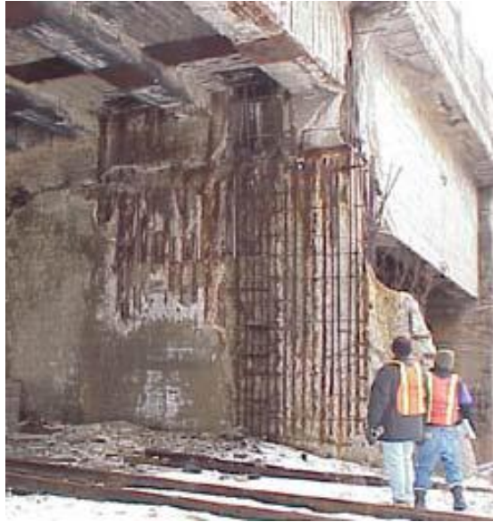
Figura 2.4 - Estrutura de betão de cimento Portland normal em elevado estado de degradação (Pacheco-Torgal, et al., 2010).
