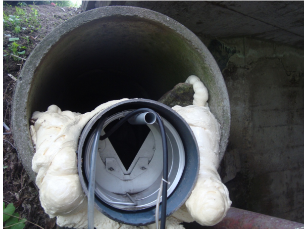
Figura 3.11: Descarregador triangular de 12” colocado no interior do coletor de 600 mm
