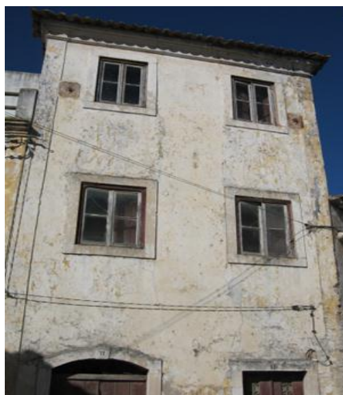
Figura 9 - Edifício bastante degradado (fonte: Google images)
