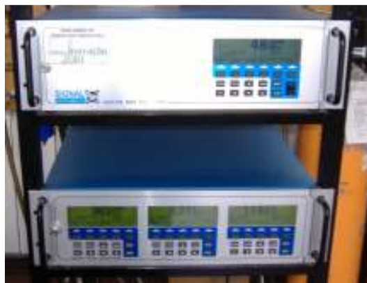
Figura 3.11: Analisador de gases, acoplado à caldeira
