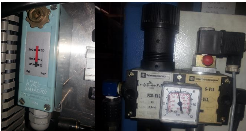
Figura 6.5 Sensores de pressão do sistema de ar comprimido do equipamento
