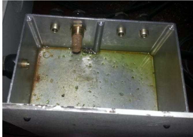
Figura 6.9 Bacia de escape do sistema de ar comprimido
