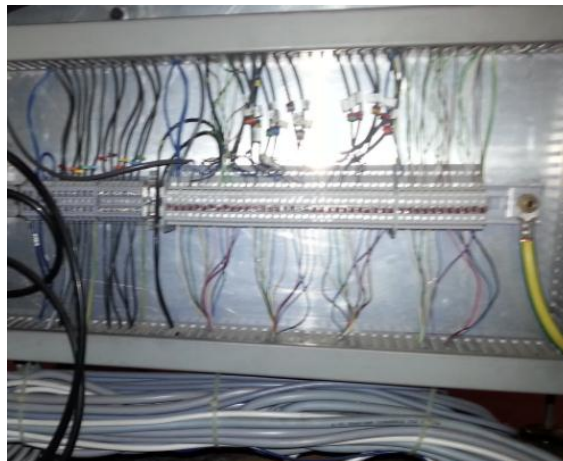
Figura 6.3 Quadro elétrico da máquina-ferramenta em análise
