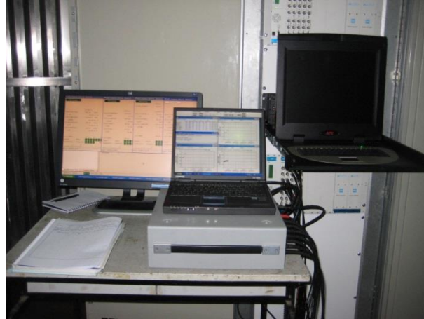
Figura 37 – Equipamentos utilizados durante os ensaios na central do Alto Rabagão (cablagens de interface entre equipamentos visível)
