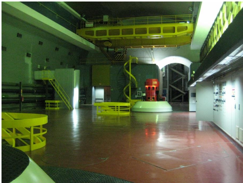
Figura 35 – Sala de máquinas da central do Alto Rabagão
