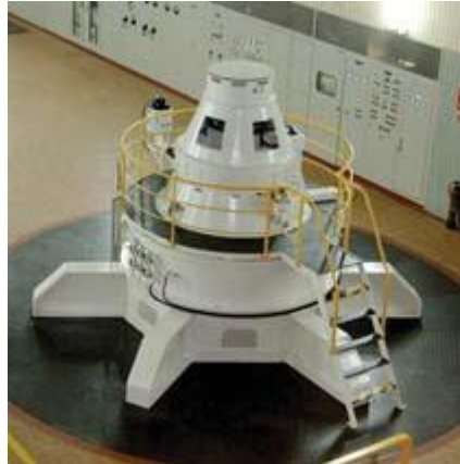
Figura 27 – Grupo gerador J. M. Voith da central de Caniçada (adaptado de Brochuras dos Centros Produtores EDP, 2011)
