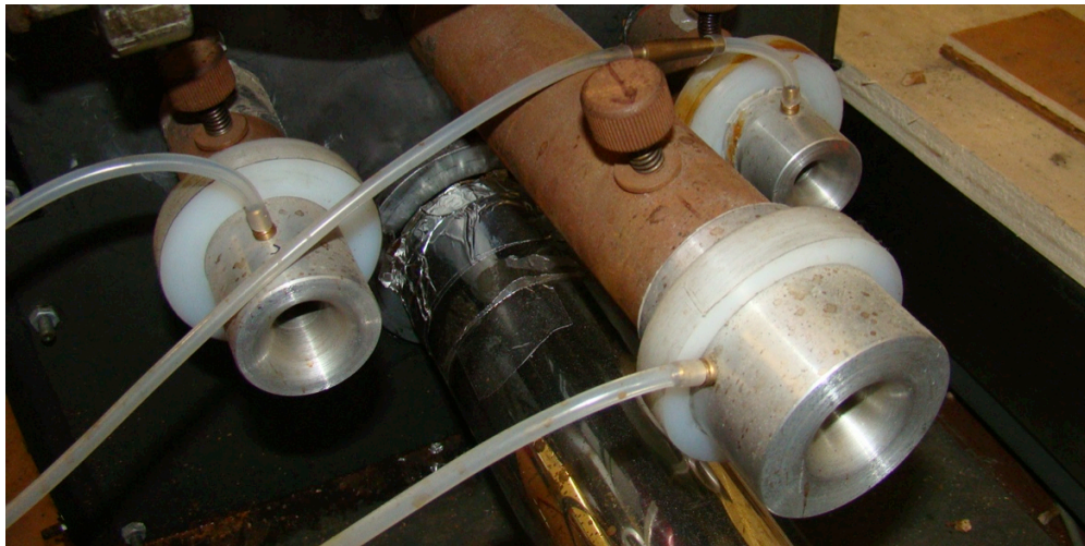
Figura 3.3 - Admissão e tubeiras do queimador da caldeira utilizada na instalação.
