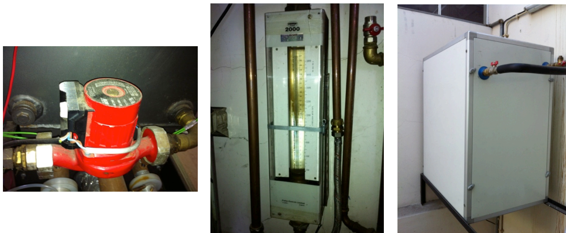
Figura 3.9 - Componentes do sistema de dissipação de calor. Da esquerda para a direita: Bomba de circulação; Rotâmetro; Ventiloconvector
