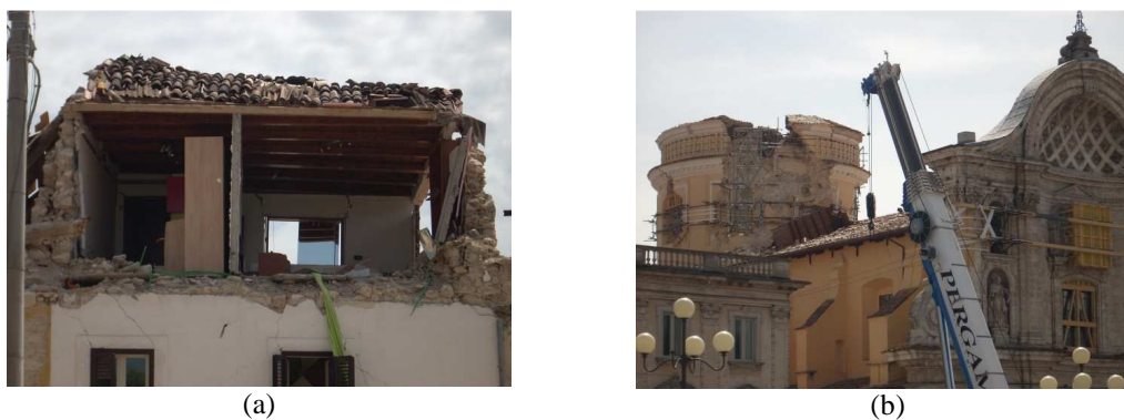
Figura 2 – Exemplos de danos ocorridos em edifícios de alvenaria de pedra, Itália 2009: (a) edifício habitacional em Onna; (b) colapso da cúpula de S. Massimo em L'Aquila.
