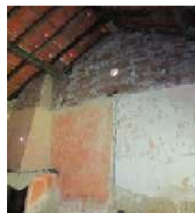
Figura 38- Alçado Norte (interior), em alvenaria de pedra, coberta por reboco de cal; no topo apresenta um óculo com moldura granítica; apresenta também lareira adossada à parede.
