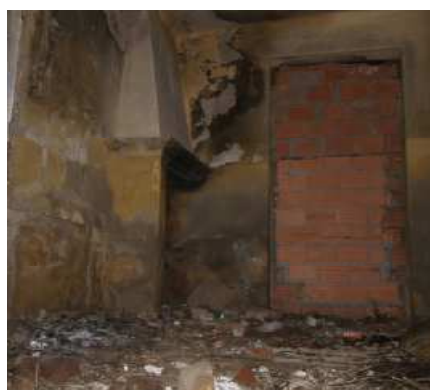
Alçado Norte (interior), bastante danificado.
