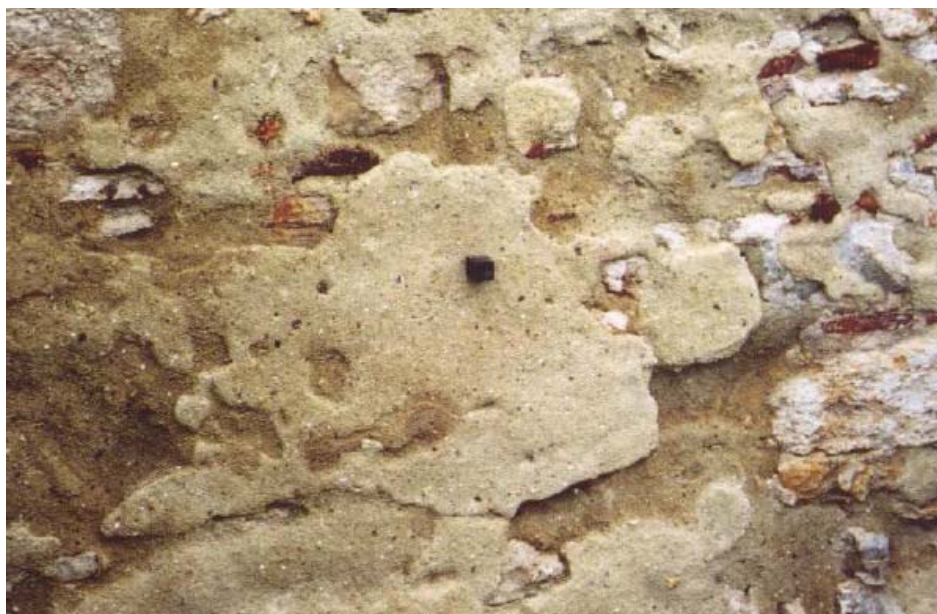
Figura 4 – Perda de coesão e erosão em argamassa recente de cal hidratada com gordura [7]
